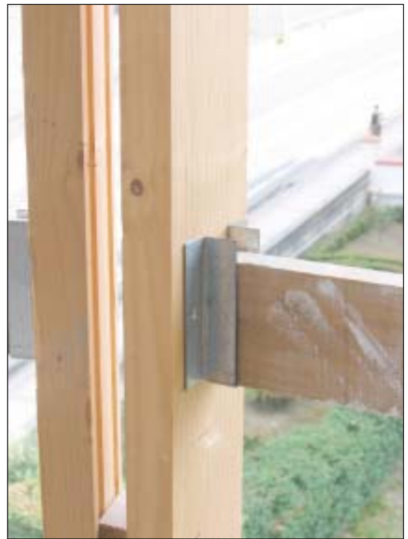
Protecciones de huecos
