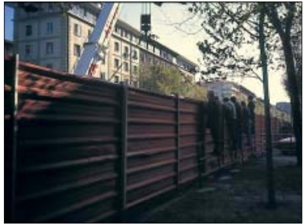
Vallado de obra
