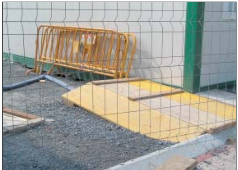
Protección de conducciones
