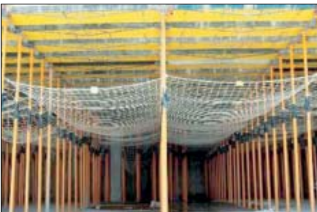
Redes bajo forjado
