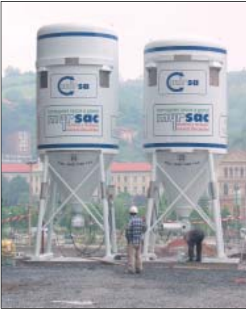
Silos para mortero con mezclador
