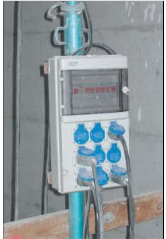
Cuadro eléctrico auxiliar
