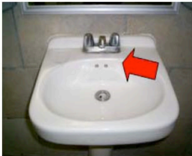
Fuga de agua lavamanos baño hombres Resp. Mantto
