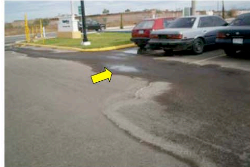
Sistema de riego en mal estado Resp. RH / Guardias
