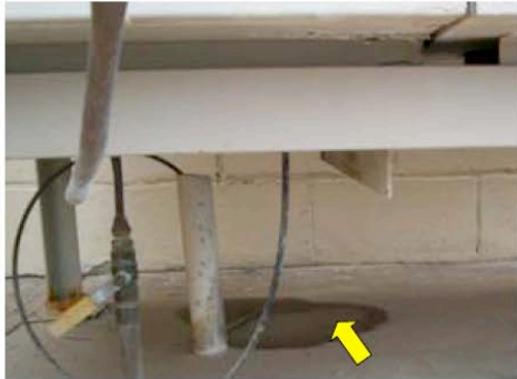
Fuga de agua en aire del comedor Resp. Mantto
